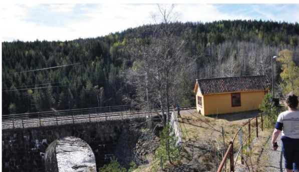
Steinbro og tostasjon ved Bøylefoss
